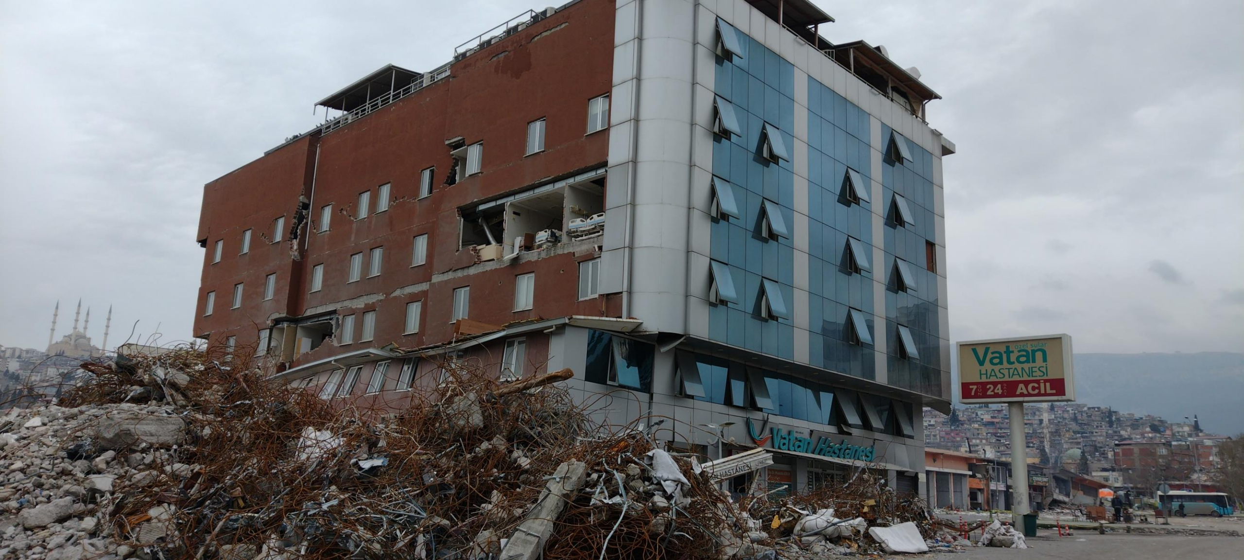
Hospital dañado en Kahramanmaras que no pudo dar el servicio durante la emergencia y tuvo que ser demolido en semanas posteriores.
